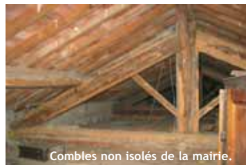
Combles non isolés de la mairie.
